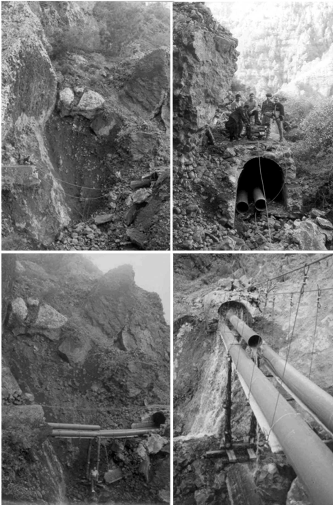
Fig. 21. Diferentes imágenes que muestran los daños provocados por un desprendimiento en el canal Dos Aguas – Los Barros después de haber sido recubierto. La avería se resolvió mediante la instalación de tubos provisionales.
