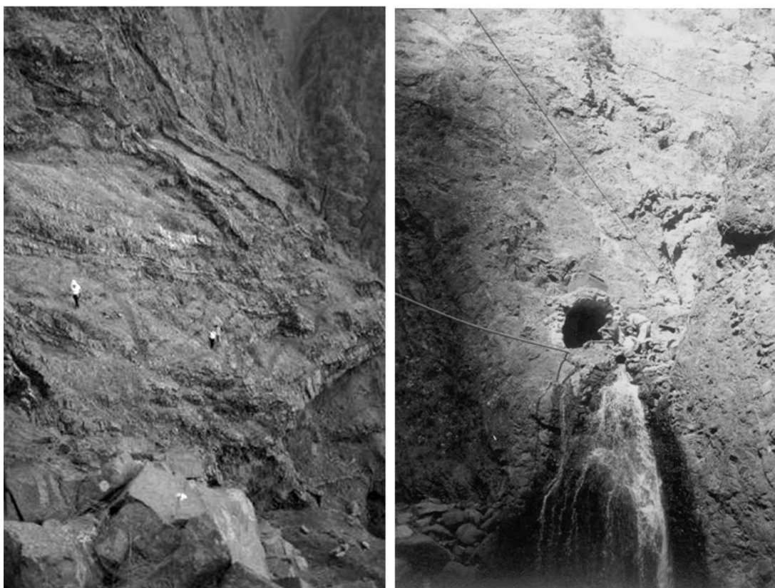
Fig. 10. La accidentada orografía de La Caldera con paredones de muy difícil acceso ofreció elevadas dificultades para llevar a cabo el trabajo de perforación de las galerías.
