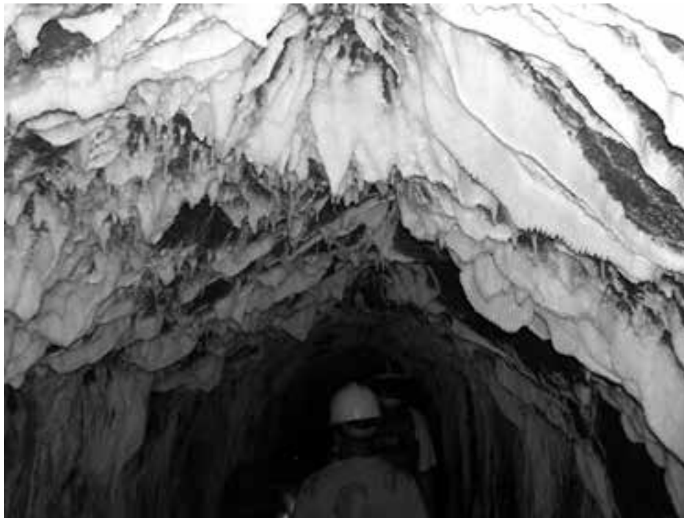
Fig. 8. Precipitaciones de carbonatos en el interior de la galería La Cerca (Garachico, Tenerife) como consecuencia de un proceso de desgasificación de dióxido de carbono ( \text{CO}_2 ) procedentes de aguas subterráneas con altos contenidos en bicarbonatos ( \text{HCO}_3^- ).
