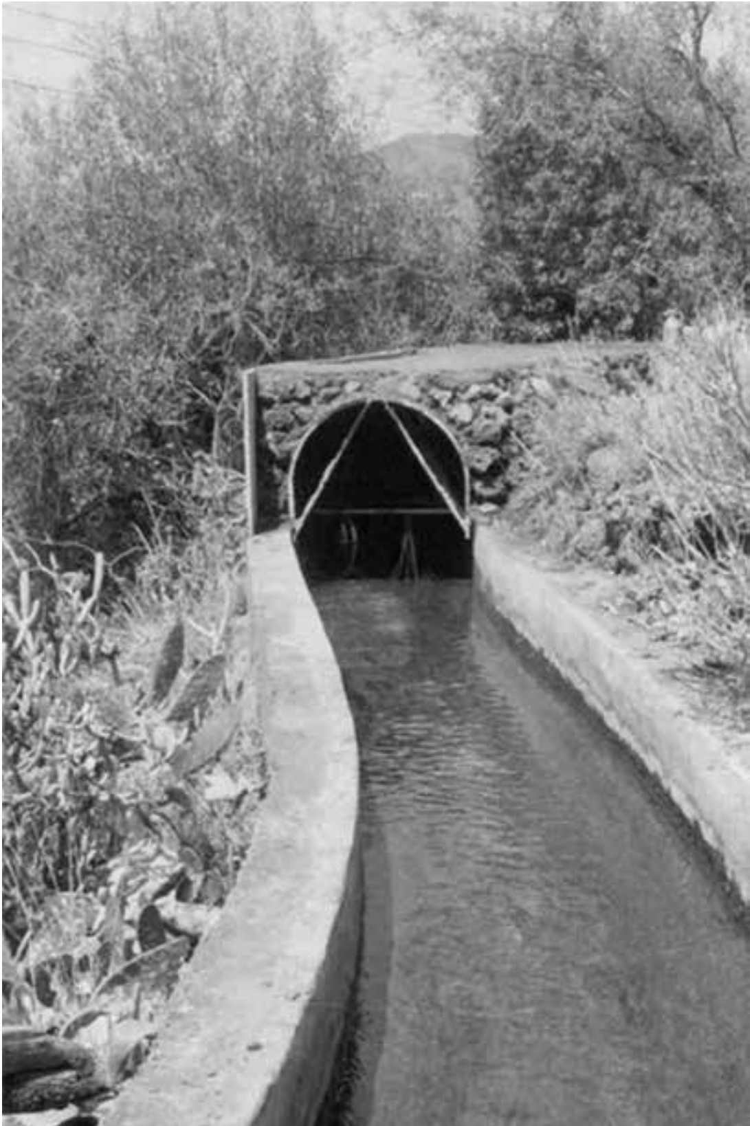
Fig. 20. Detalle del canal Dos Aguas – Los Barros en el que se observan las obras de recubrimiento que evitan daños provocados por los desprendimientos.
